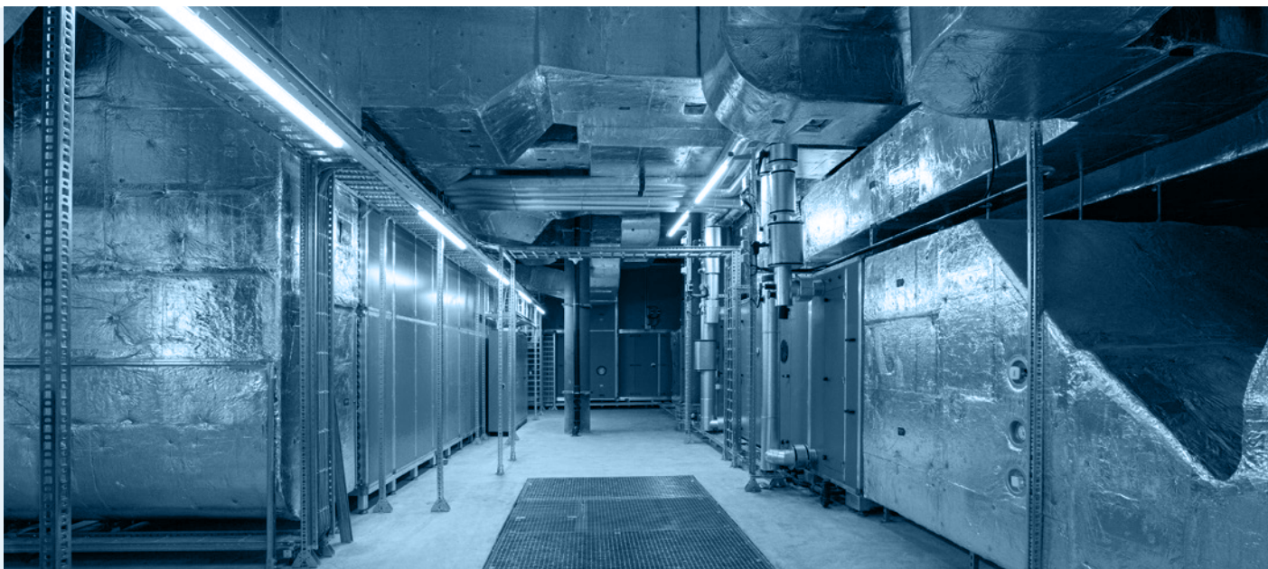
Sistema de aire acondicionado de un centro comercial en Zúrich - ©balakate/123RF.COM
