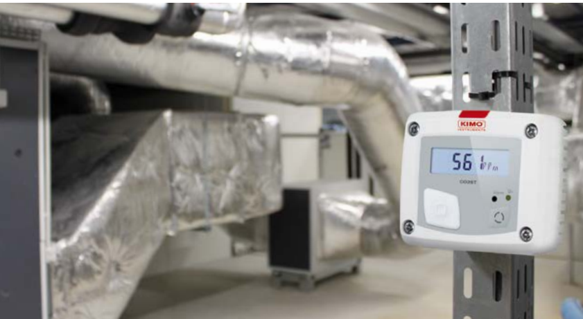
CO2ST instalado en el local de tratamiento del aire de una infraestructura industrial.
