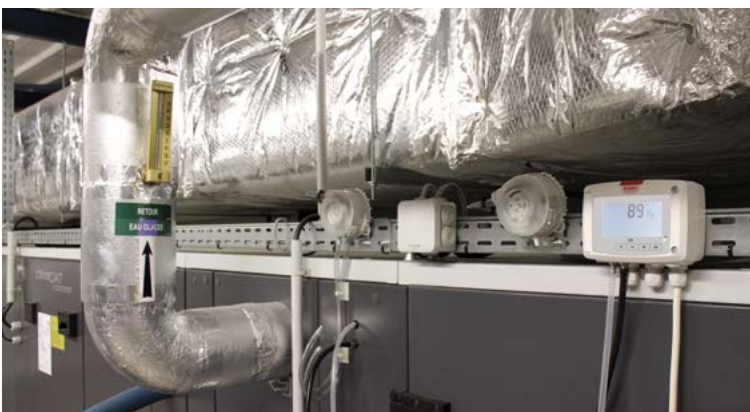
CP 210-R en la sala de tratamiento del aire de una infraestructura industrial.
