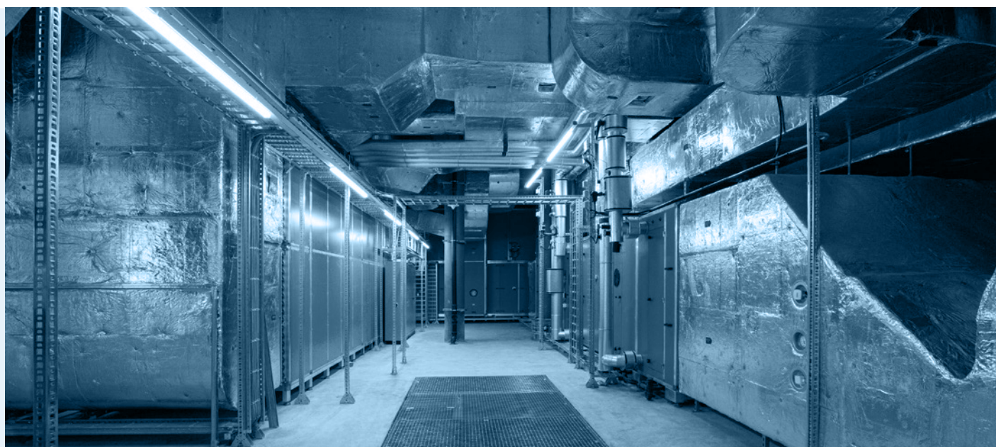
Klimaanlage eines Einkaufszentrums in Zürich - ©balakate/123RF.COM
