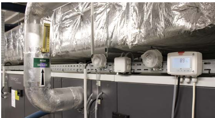
CP210-R in der Lüftungsanlage einer Industrieanlage.
