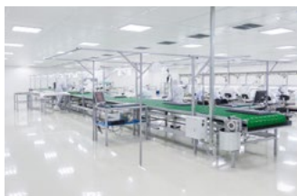
Überwachung und Regelung von Differenzdruck, relativer Luftfeuchtigkeit, Temperatur, Luftgeschwindigkeit und Luftwechselrate in Reinräumen und Operationssälen
