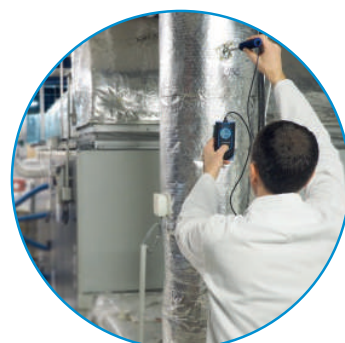
测量管道内的风速, 风量和温度
