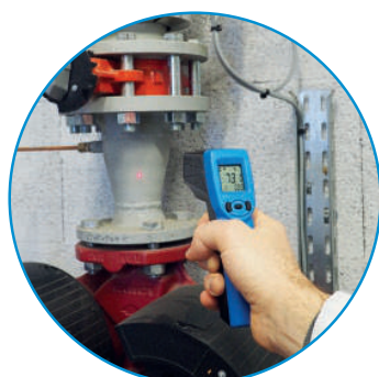
检查家用热水系统出入口处的温度
