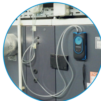
测量空气处理设备入口和出口的过滤器之间的差压
